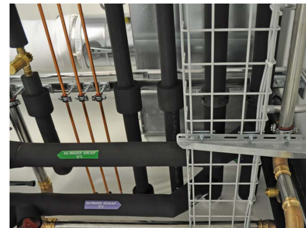
Medienversorgung auf mehreren Ebenen
